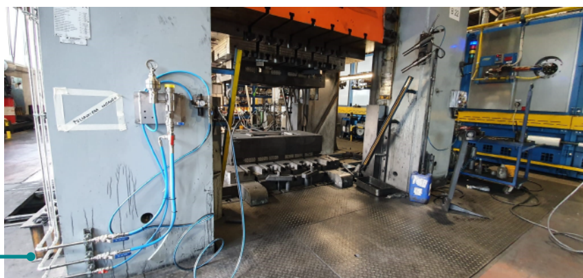
Linea centralizzata in arrivo a postazione macchina e linea ricircolo
